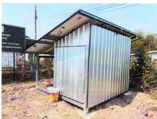
โครงการก่อสร้างระบบสูบน้ำด้วยพลังงานอาทิตย์เพื่อการเกษตร บ้านปากอ้อย หมู่ที่ ๑๑
